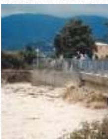
Pont sur la Sauve en 1993, érosion de la berge en rive gauche au niveau de la culée du pont (Nyons). (Source photographique : Ph. COMBES)
