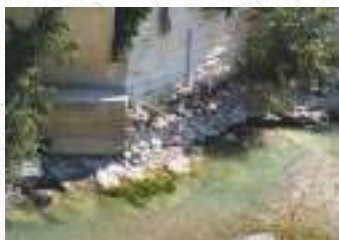
Incision du lit le l'Eygues au niveau du pont roman de Nyons (-2m) qui met à jour les bases de cet ouvrage et les expose à un affouillement par la rivière. (© SMBP)
