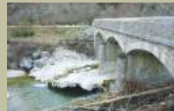
Embâcles sous une des arches constituées par des végétaux de grandes tailles et affouillement du seuil au pont de Cornillon. (Source photographique : SIDRESO)
