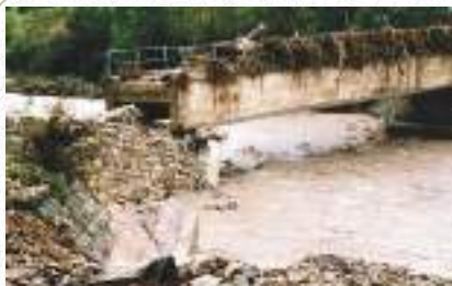
Pont gravement endommagé lors de la crue de l'Ennuye le 22 septembre 1992 (Arpavon).
